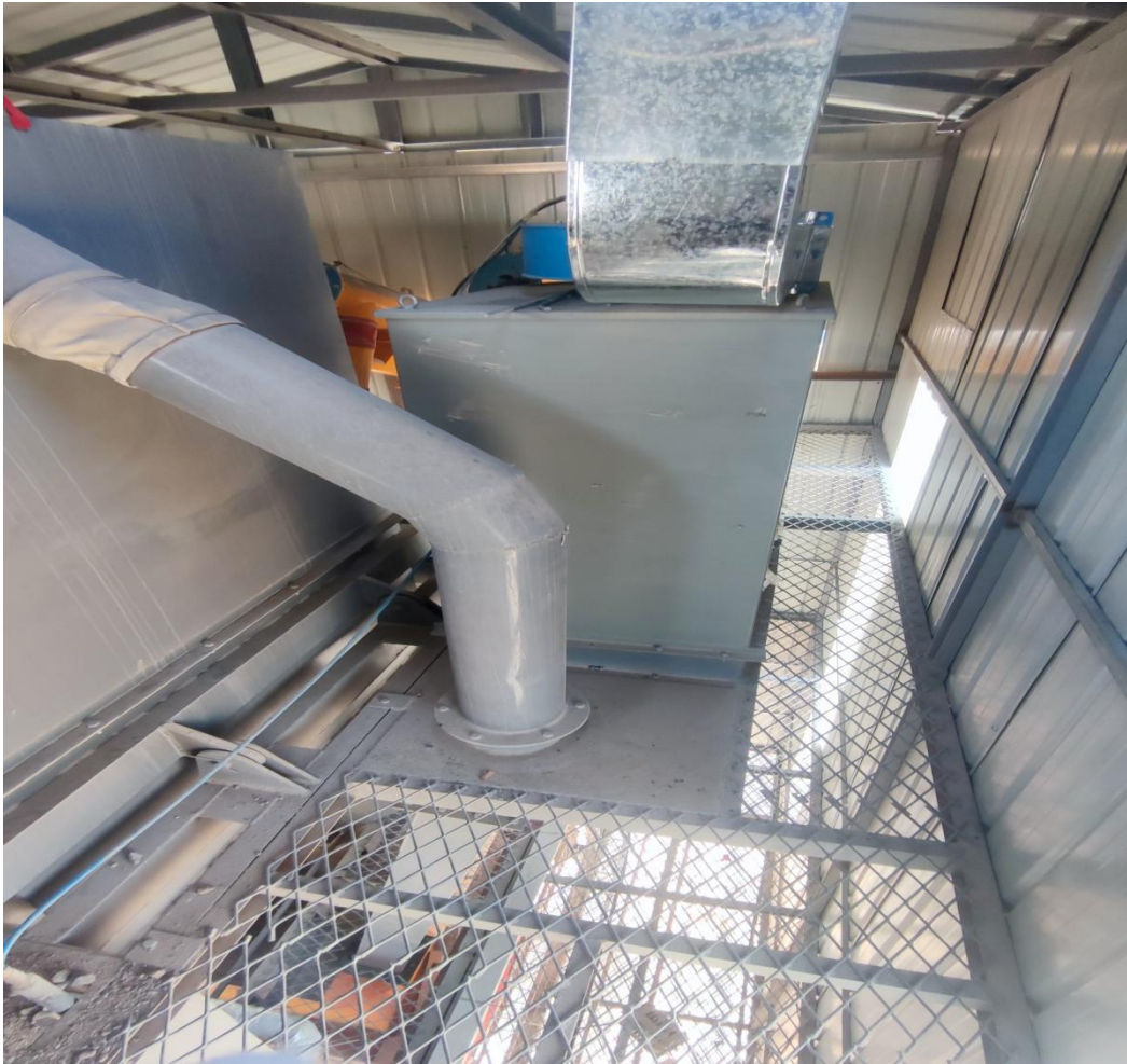
图 3-4 废气治理设施及排气管道
