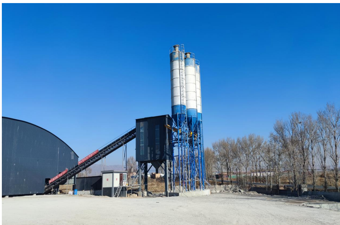
图 2-1 HGS180 混凝土生产线
